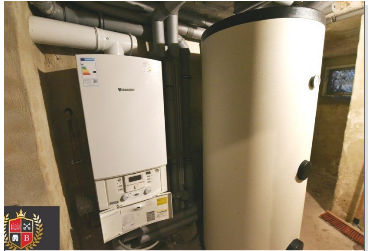
Die Gaszentralheizung im Keller
