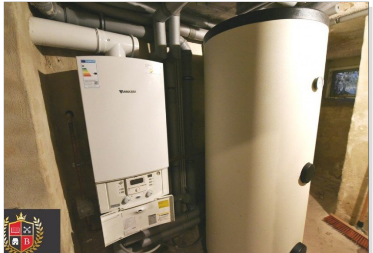
Die Gaszentralheizung im Keller
